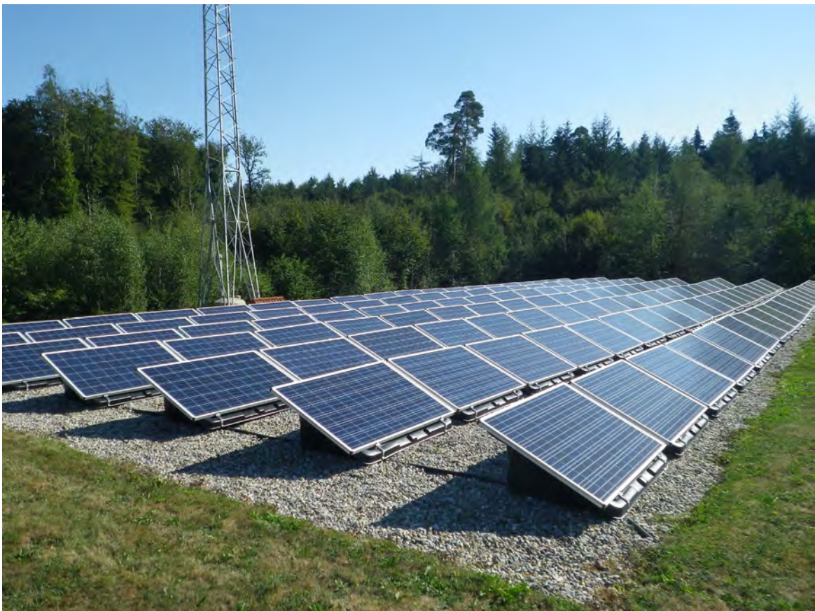
Photovoltaikanlage auf dem Hochbehälter Birket
